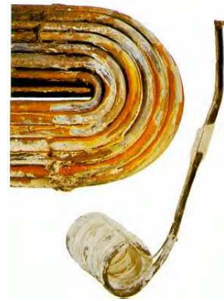
Verkalkung auf Heizschleifen
