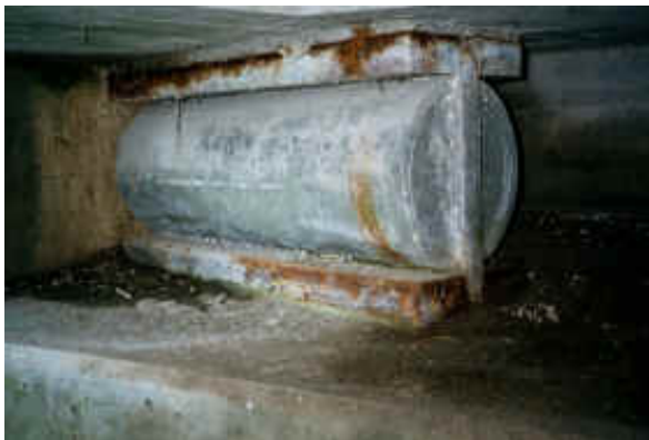
Rollenlager einer Brücke mit beginnender Korrosion
